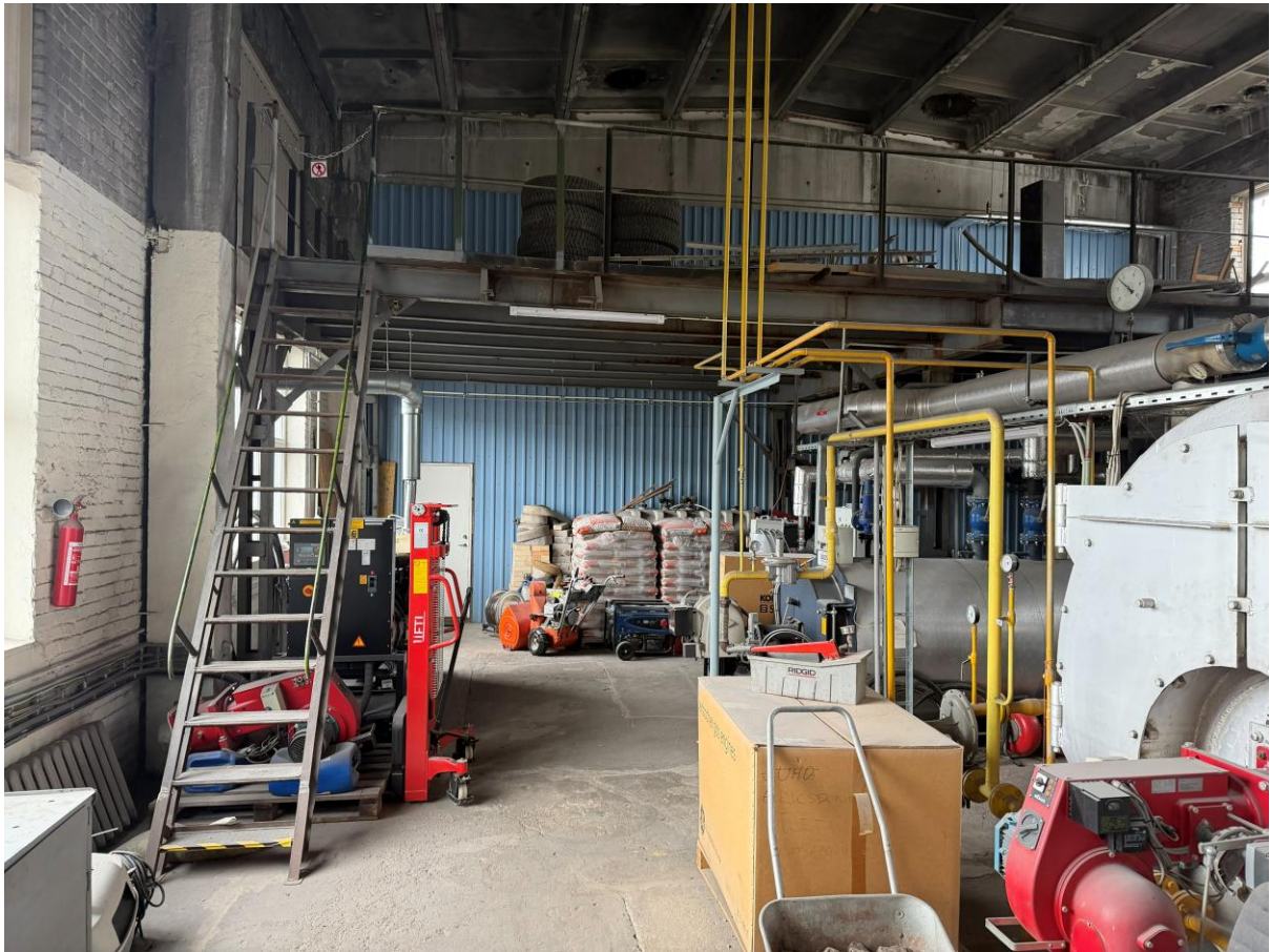
Soojussalvesti võimalik asukoht
